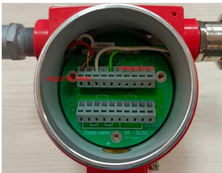
Рис.5 Неправильный монтаж, не должно быть оголенных проводов
